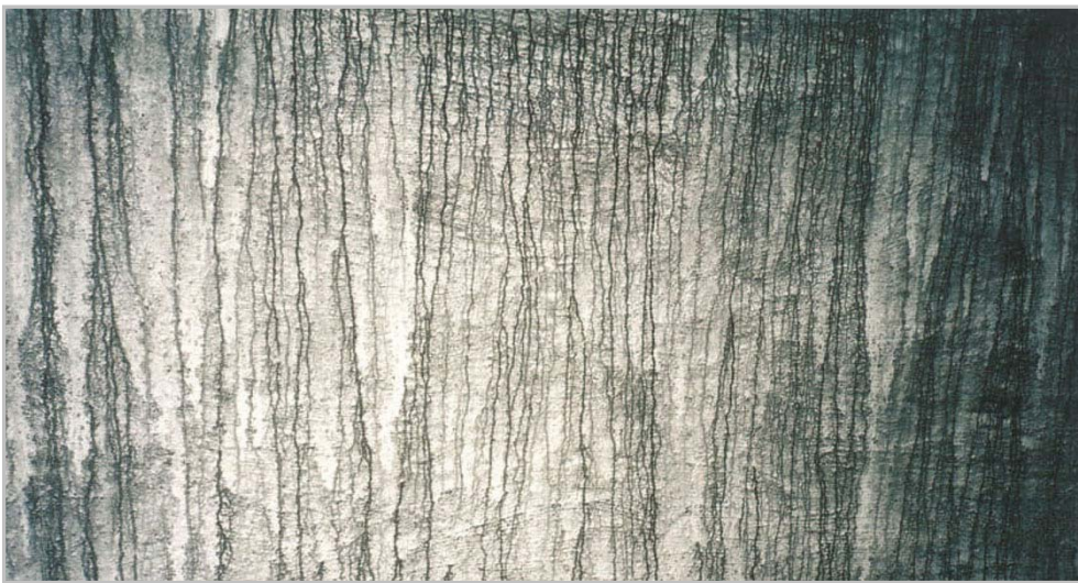
Figur 5. Väggen i sakristian efter branden. Kondens skapade ränderna i den sotiga ytan (foto Ulf Alström).
