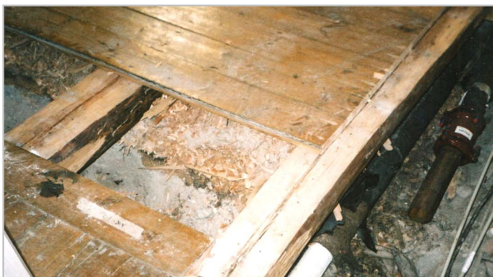
Figur 14. En kanal i spånlagret efter sugning. Resten av spånen ligger kvar. Till höger i bild syns rören från 1937 års värmeinstallation (foto Ulf Alström).
