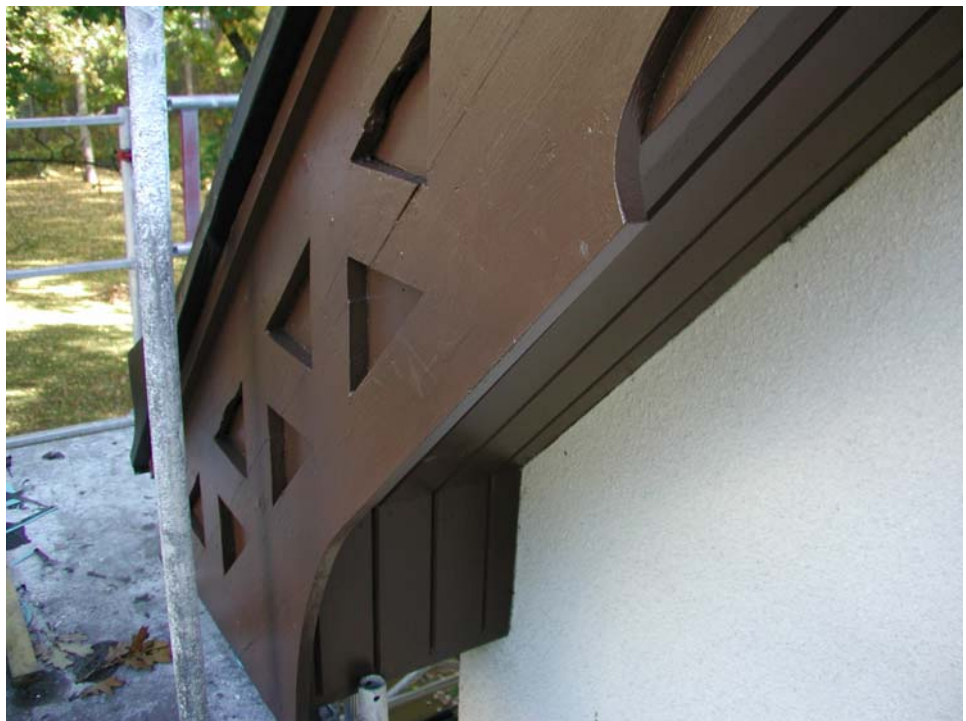
Figur 5, överst t.v. Rostskador på plåt. Foto: VLM.
