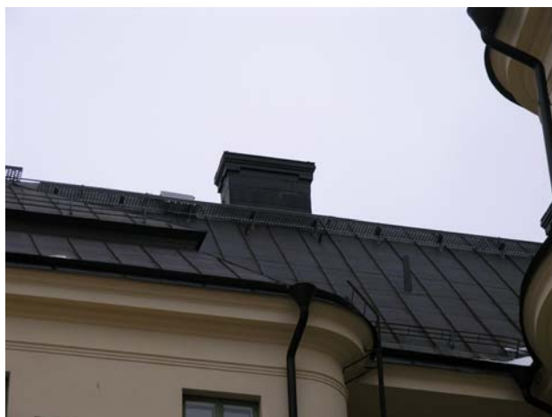
Figur 4: Baksidans takfall. Takplåtarna ligger med tvärfalsar som inte är förskjutna.
