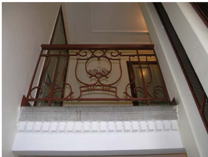
Figur 23: På tredje våningen avslutas trapphuset med ett smidesrücke. Det underliggande tandsnittet förekommer på samtliga plan.
