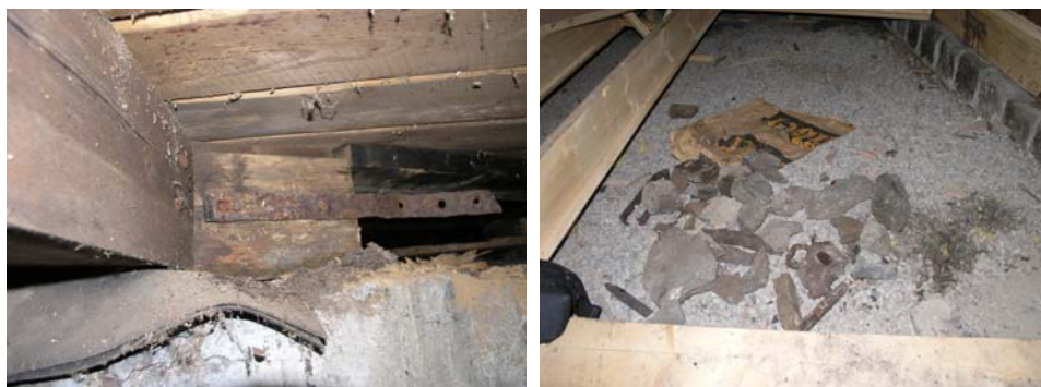
Figur 13 t.v. Järn som sammanband den raka skarven i bjälkens vänstra del sett från schaktet. Som synes var takbjälken endast ihopfäst med spikförband med den bjälke som byttes. När bjälken byttes tappade det järn som band samman skarven sin funktion. Istället för att sätta tillbaka järnet som dekoration utan funktion sattes det som ett hörnjärn mellan utbytt bjälke och takbjälken till vänster i bilden. Under den något mer moderna lagningen bar fö. lagts tjärpapp. Figur 14 t.h. Järnskröt mm funnet under golvet. Foto KM.
