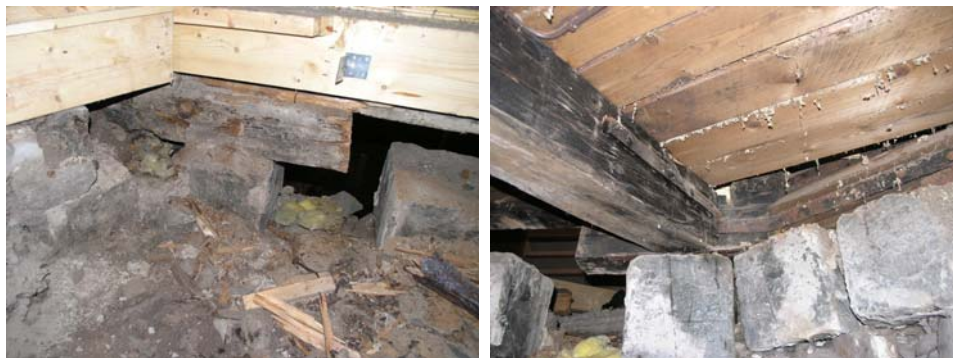
Figur 11 t.v. Avtagen bjälke under dörrkarm. Muttern syns strax under de moderna reglarnas vinkel. Bjälken fortsätter en liten bit till vänster om muttern. Hela denna del byttes på grund av röta. Foto KM.
