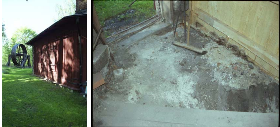
Figur 5 t.v. Exteriör av gruvmuseet. Marken lutar in mot grunden vilket åtgärdades.
