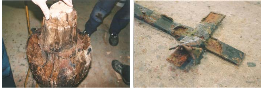
Figur 36. Träkärnan till spiran med kraftiga rötskador. Foto KM.
