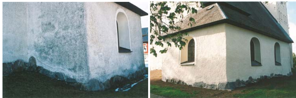
Figur 8. Algangrepp på sakristians sydöstvagg före renovering. Foto KM.
