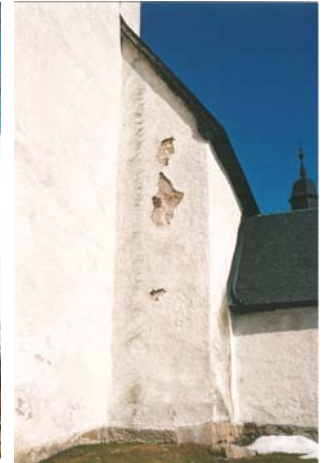
Figur 11. Stora putskläpp i anslutning mellan torn och långhus, sydväst. Foto KM.
