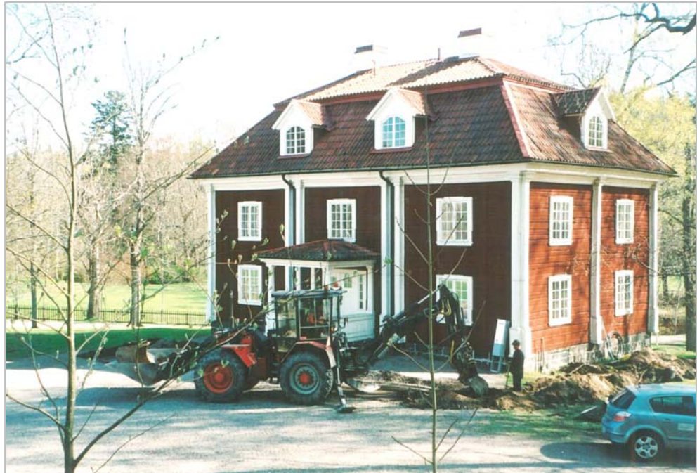
Figur 2. Grävningens arbetet påbörjades från den södra kortväggen. Schaktet fortsatte över gårdplanen för att sedan vika av mot den norra kortväggen (foto Ulf Alström).
