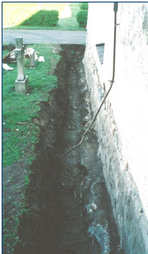
Figur 13. Den så kallade Davidskyrkans södra mur efter schaktningen. Undergrunden har samma bredd som övriga muren. Det som sticker ut i undergrunden är betongrester från 1985 års arbeten som sitter kvar efter grävningen. (Foto U. Alström).
