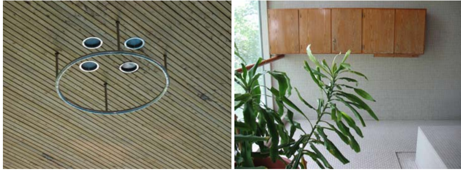
Figur 45. Vattendusch i taket över stora simbassängen.
