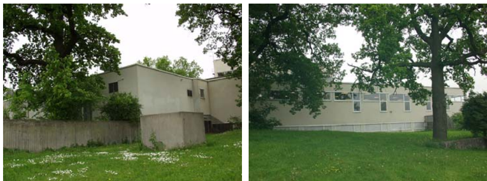
Figur 21. Östra fasaden, anslutning till den tillbyggda byggnadsdelen. Figur 22. Östra fasaden med ett långt smalt fönsterband som bryts av vertikala fönster.
