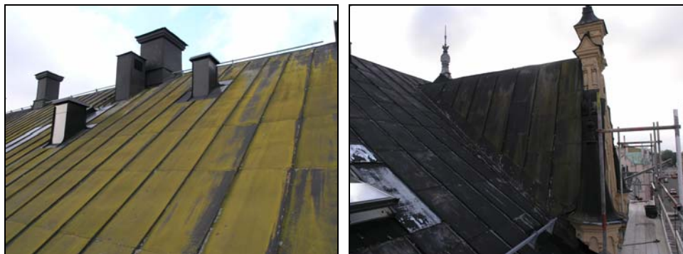
Figur 9. Takfallet på stora buset in mot gården med kraftig algpåväxt. Foto KM.
