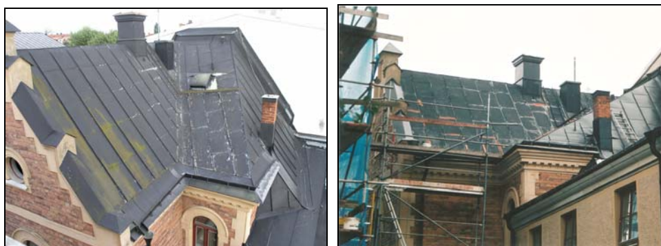
Figur 11.: Lilla busets takfall in mot gården före renoveringen. Mindre del med algpåväxt. Foto KM.
