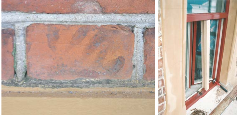
Figur 45. Handavtryck i teglet samt rundstrukna fogar. Foto KM. Figur 46. Utbyte av mittpost på fönster i nedre våningen. Foto KM.
