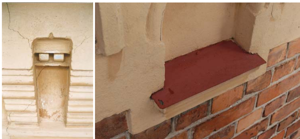
Figur 27. Äldre färgsättning synlig på takfotslisten mot gatan. De små Guttaedropparna är tillverkade i stucc och är målade med grå linoljefärg. I övrigt fanns inga spår av linoljefärg utan övriga delar är tillverkade i puts och målade med fasadfärg. Vid ommålningen 2006 missades de ljusgrå dropparna. Foto KM.
