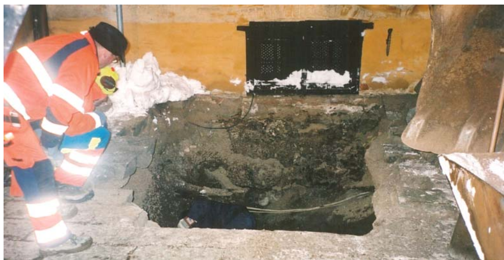
Figur 3. Platsen för vattenläckan intill SÖ hörnet på borggården. (Foto: Ulf Alström).
