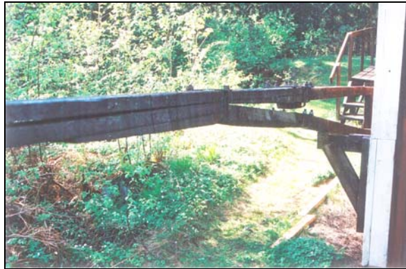
Figur 10. Sydvästra vevaxelarmen före renoveringen. Anslutning mot stånggången bestående av sammanspikade bräder
