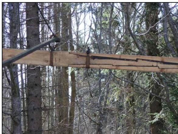
Figur 12. Exempel på blixtskarv på stånggångens södra sida.
