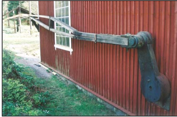
Figur 13. Nordöstra vevaxelarmen före renoveringen.
