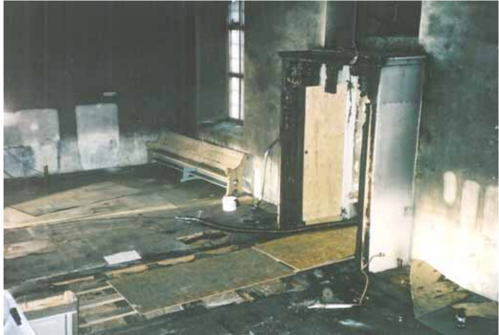
Figur 4. Kyrkans norra brandskadade ingång med det skadade golvet. (Foto Ulf Alström).
