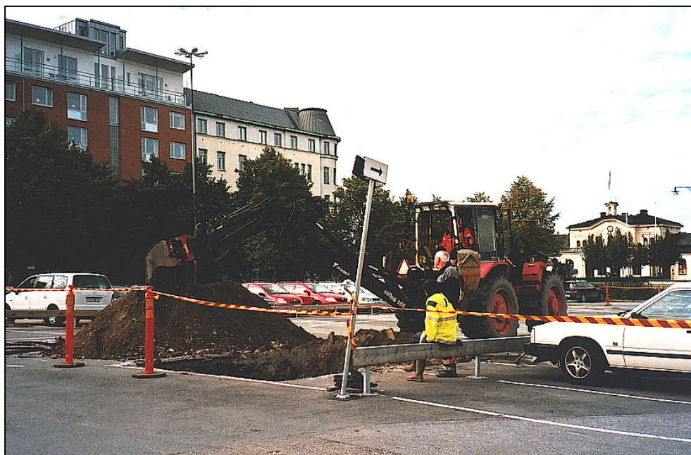
Figur 2. Schaktning i kvarteret Porten. I bakgrunden järnvägsstationen. Till vänster i bild kvarteret Fåfången där arkeologiska undersökningar genomfördes 2004. (Foto Ulf Alström).
