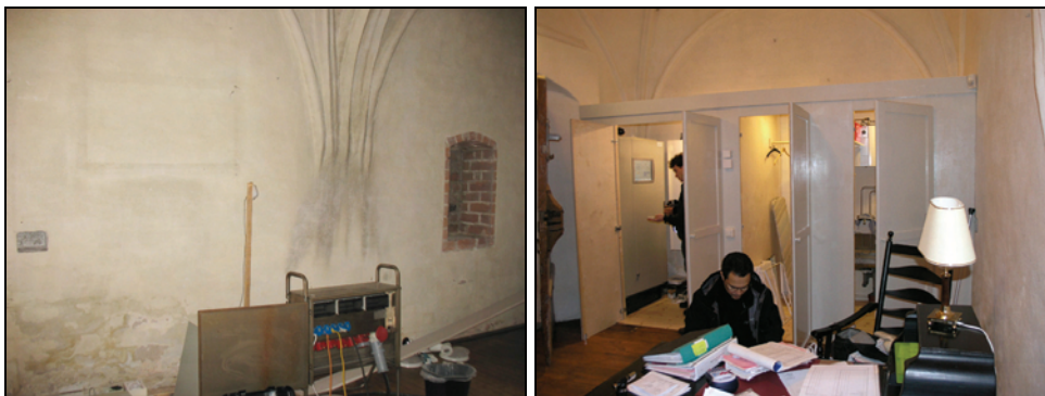
Figur 17. Smutsiga väggar i sakristian före rengöringen. Foto: Helén Sjökvist.
