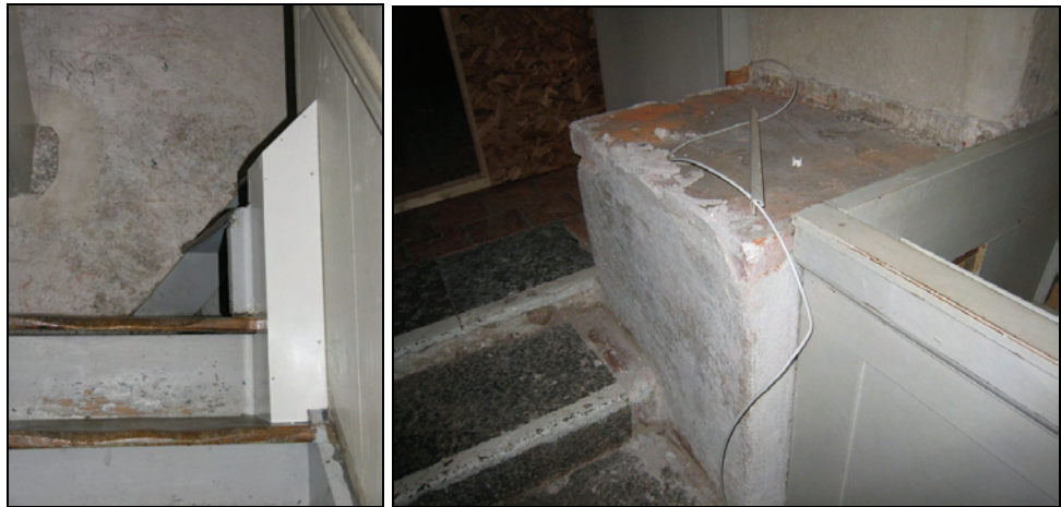
Figur 23. Låda som döljer nya eldragningar i trappa. Äldre dragningar utmed vangstycket är bortmonterade. Foto: Helén Sjökvist.
