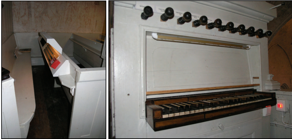
Figur 27. Ny styrpulpit för ljud placerad längst ned i norra bänkkvarteret. Foto: Helén Sjökvist. Figur 28. Ny ljuslist över orgelns spelbord. Foto: Helén Sjökvist.
