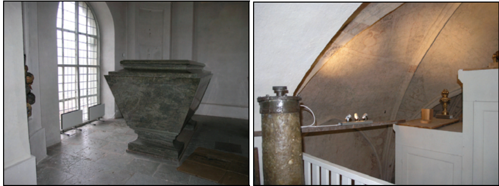
Figur 21. Nya radiatorer på fötter i gravkoret. Foto: Helén Sjökvist.
