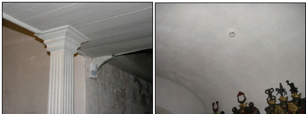
Figur 25. Rörelsedetektor monterad under läktartrappa. Foto: Helén Sjökvist.
