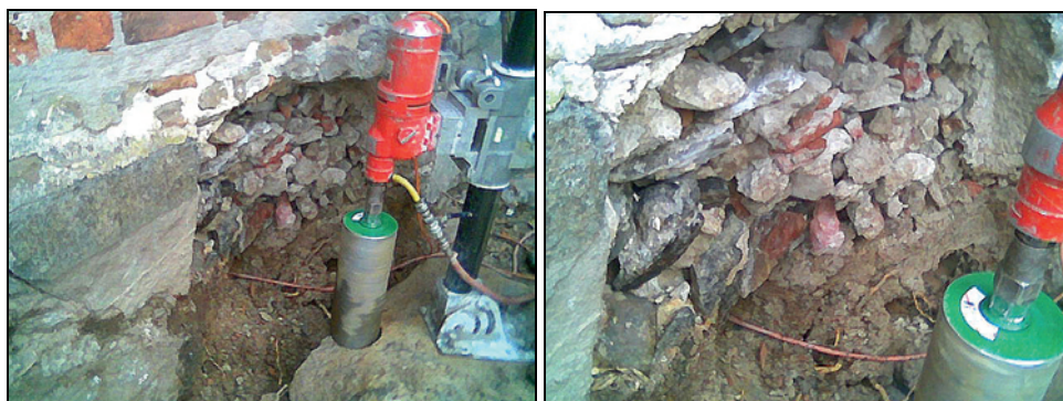
Figur 3 och 4. Vid borrningen vid sakristian föll en av de stenar som tycktes ligga som en grundmur. Bakom denna visade det sig finnas en skalmursfyllning av tegel, bruk och mindre naturstenar. Foto: Helén Sjökvist.
