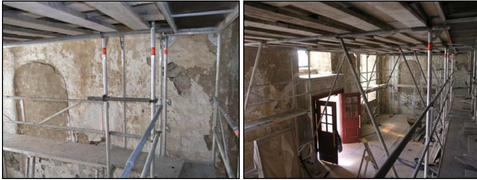
Figur 10. Det igensatta fönstret på västväggen skiljer sig från omgivande ljusa kalkrika puts genom den lerhaltiga, mörkare 1790-tals putsen. Strax till höger om fönstret syns rester av en rosa kulör. Figur 11. Putsen nedbilad från väggarna i södra korsarmen.
