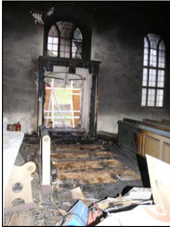
Figur 59. Norra vindfånget direkt efter branden.
