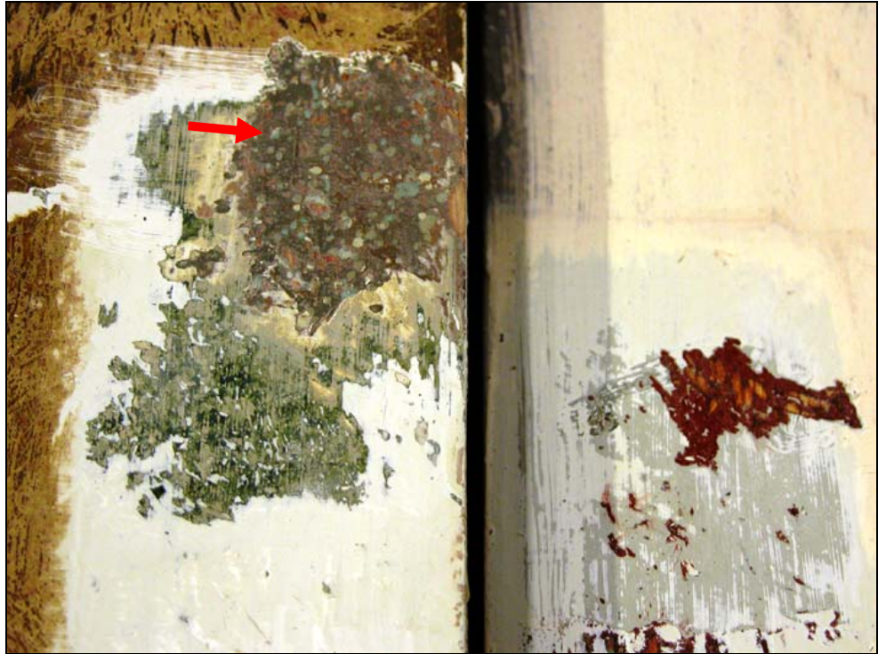
Figur 40. Vid pilen syns den grå kulör som återfinns som understa lager. Nedan denna syns den senare gröna marmoreringen. Till höger syns den röda färgtonen på omfattningen samt den senare grå kulören. Foto: Anders Persson.
