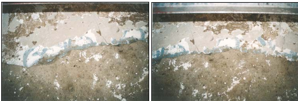
Figur 22-23. Bården framträdde tydligast över den igensatta fönsteröppningen på östra väggen. Den rosaaktiga kalkfärgen ligger under den blågrå och vita färgsättningen..
