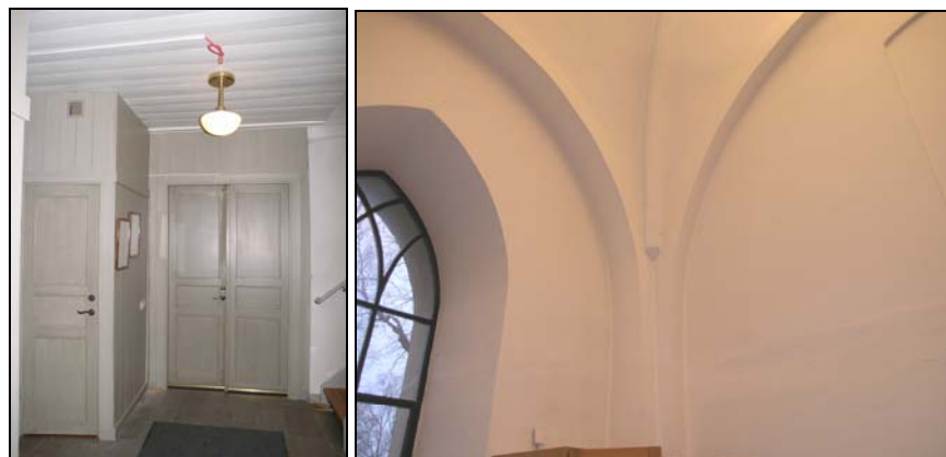
Figur. Vapenhus med västentré. Kabel dragen för magnetkontakt.
