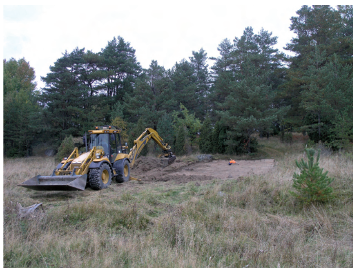
Figur 3. Utredningsytan under undersökning. Härden påträffades strax efter att fotot hade tagits. Fotograferat från söder av Maud Emanuelsson.
