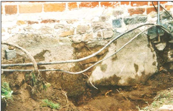
Figur 12. Sakristians västra vägg där kablar och ledningar skulle dras genom muren. (Foto U. Alström).
