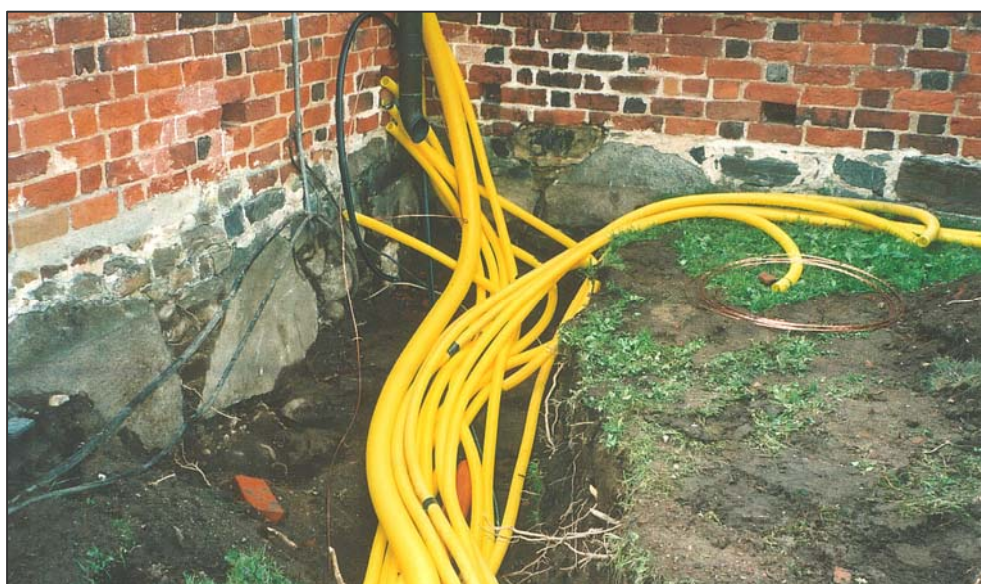
Figur 2. De gula plastslangarna antyder den mängd ledningar och kablar som drogs genom sakristians västra vägg som är till vänster om stupröret. (Foto U. Alström).
