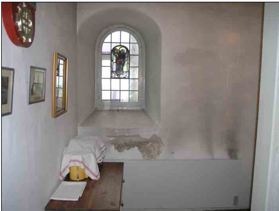
Figur 8. Putsskada under fönstret i det tidigare kapprummet. Foto: Helén Sjökvist.
