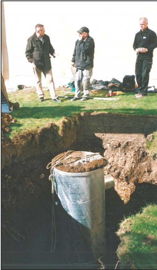
Figur 7. Radonbrunnen på plats intill kyrkans södra vägg. (Foto U. Alström.)
