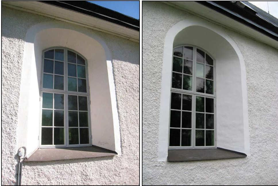
Figur 12. Fönster före åtgärder. Foto: Helén Sjökvist.
