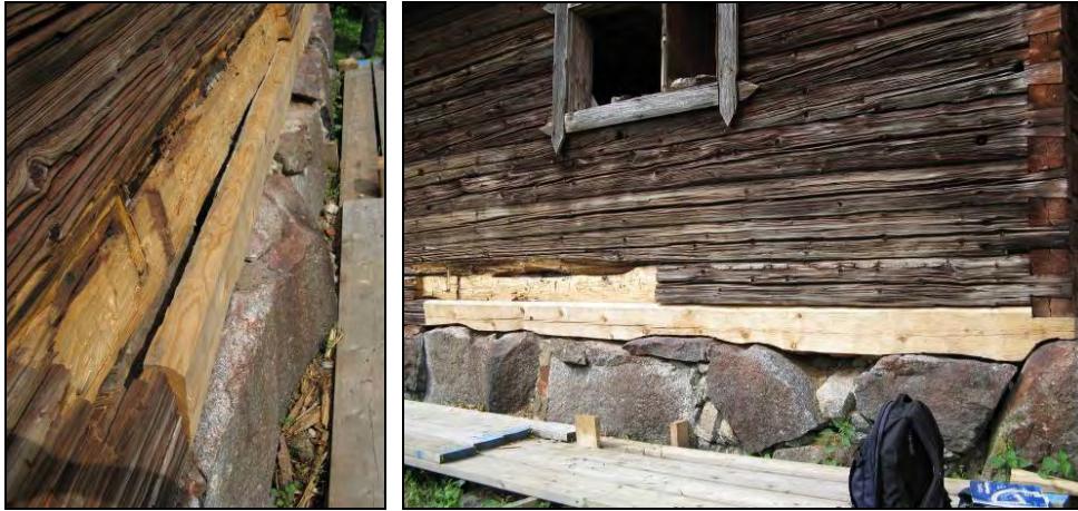
Figur 37. Södra fasaden syllbyte i östra delen. Syllen fick göras tunnare än normalt för att passa mot den gjutna klacken på insidan.
