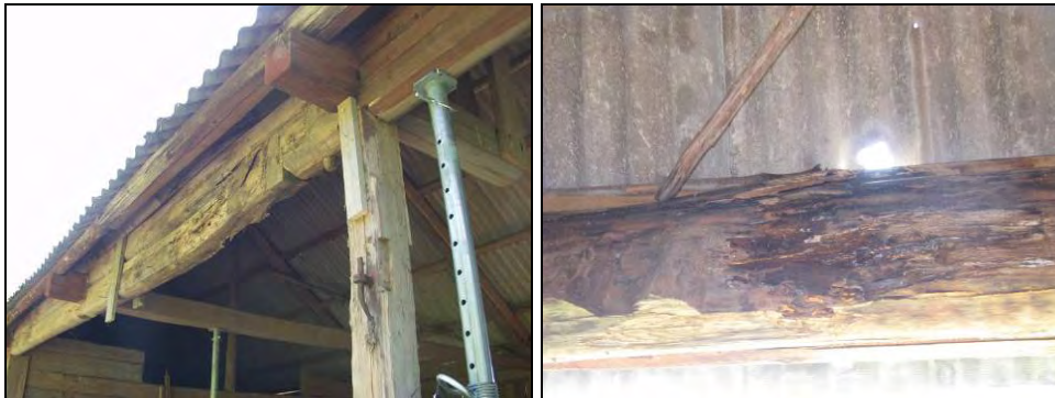
Figur 15. Norra fasaden, rötskador i hammarbandet.
