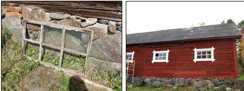
Figur 39. Skadat fönster från södersidan.
