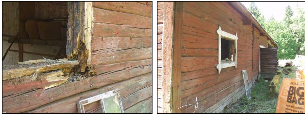
Figur 23. Norrfasadens västra fönster. Omfattande rötskador i karm och timmer. Figur 24. Norrfasadens sedd mot väster före åtgärder.
