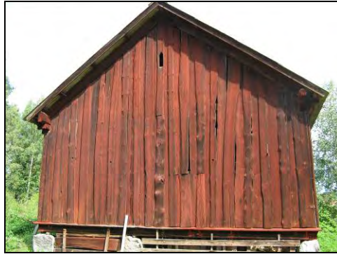
Figur 43. Västra fasaden med panel som släppt.
