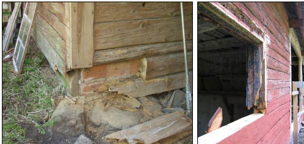
Figur 25. Norra fasaden, nordöstra hörnet, skadad syllstock. Figur 26. Norra fasadens västra fönster, timret utbytt under fönsteröppning.
