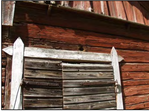
Figur 49. Rötskada över dörröppning.
