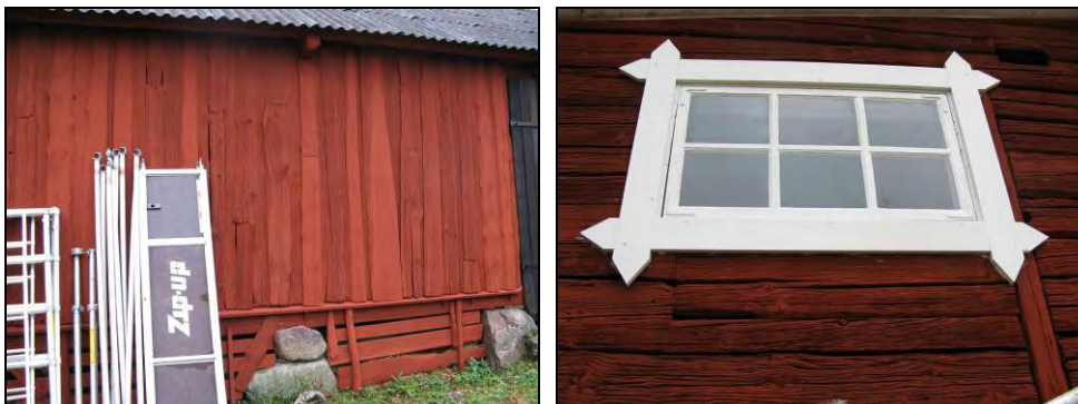
Figur 41. Södra fasaden med delvis utbytt panel, kompletteringar har gjorts med källsågat virke.
