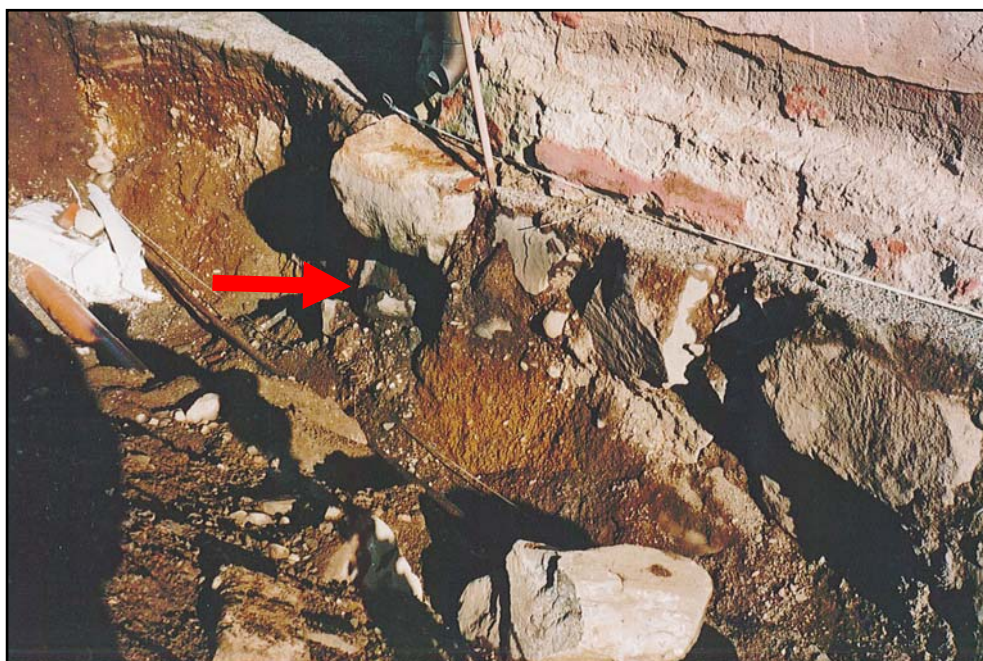
Figur 15. Kyrkans sydvästra hörn. Vid pilmarkeringen saknas en hörnsten som släppte och föll ner i schaktet. Bilden visar även på de fuktskador som muren har. (Foto U. Alström.)
