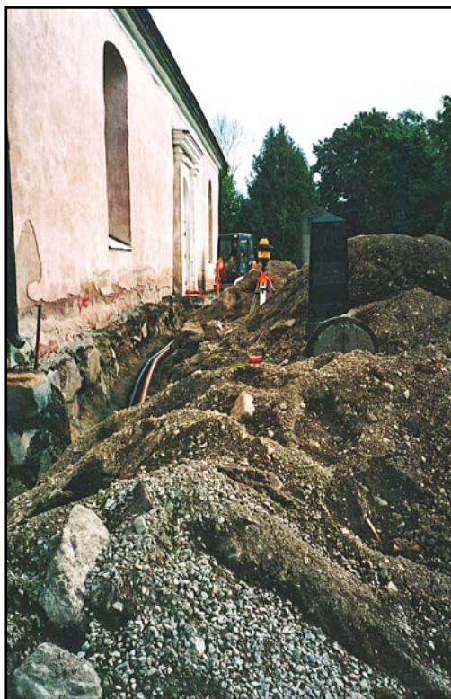
Figur 6. Kyrkogården innan återställandet. Bilden visar dräneringsschaktet vid kyrkans södra vägg. (Foto U. Alström.)
