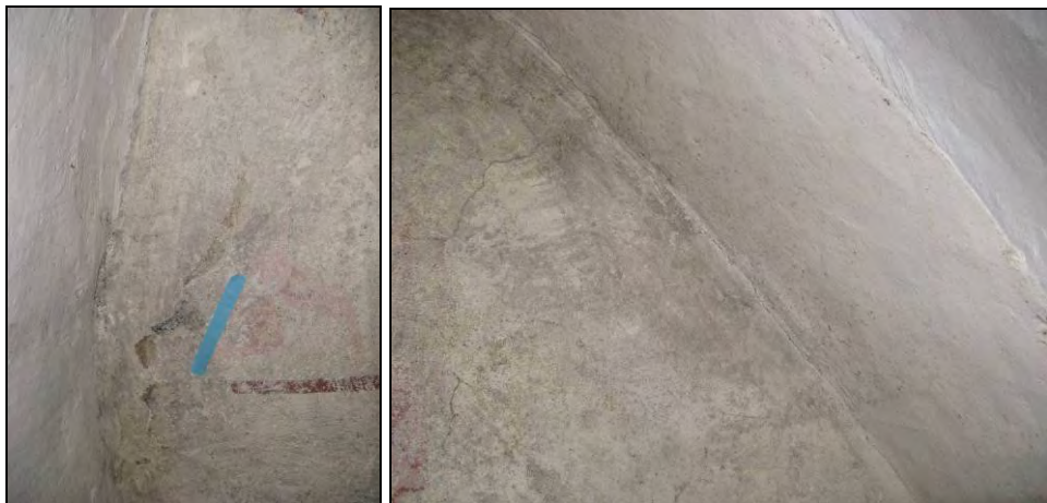
Figur 30. Mindre putsbortfall där väggens naturstenar ligger ytligt.
