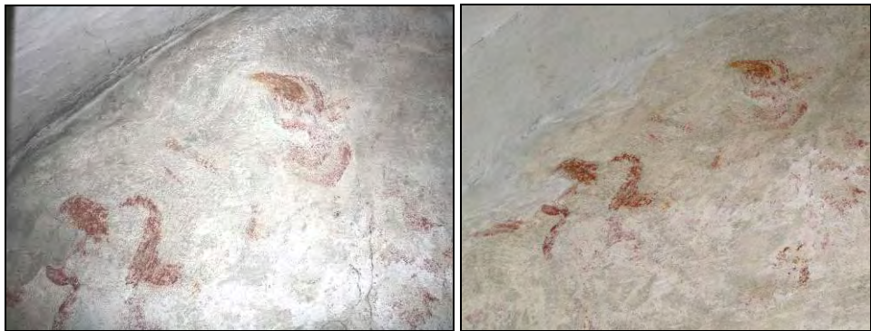
Figur 28. Djävulsfigur på vägg över vapenhusdörren. Före rengöring.
