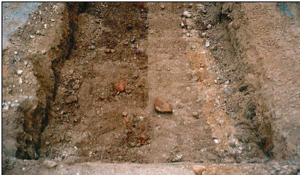
Figur 4. Flera kabel- och rörgrävningar har redan skett i Smedjegatan till olika djup varför olika kulturlager påverkats. Dessa ränder i marken representerar tre skilda schaktningar i kulturlagret. (Foto från väst U. Alström.)
