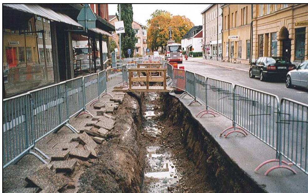
Figur 4. Fjärrvärmeschaktet i Östra Långgatan sett från norr. I schaktkanten vid trottoaren skymtar de äldre fjärrvärmerören. Under asfalten finns ett påfört lager äsmaterial. (Foto U. Alström.)
