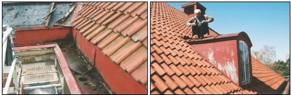
Figur 63. Gesimsränna före åtgärder. Foto: Helén Sjökvist. Figur 64. Lars Larsson på takkupa före åtgärder. Foto: Helén Sjökvist.
