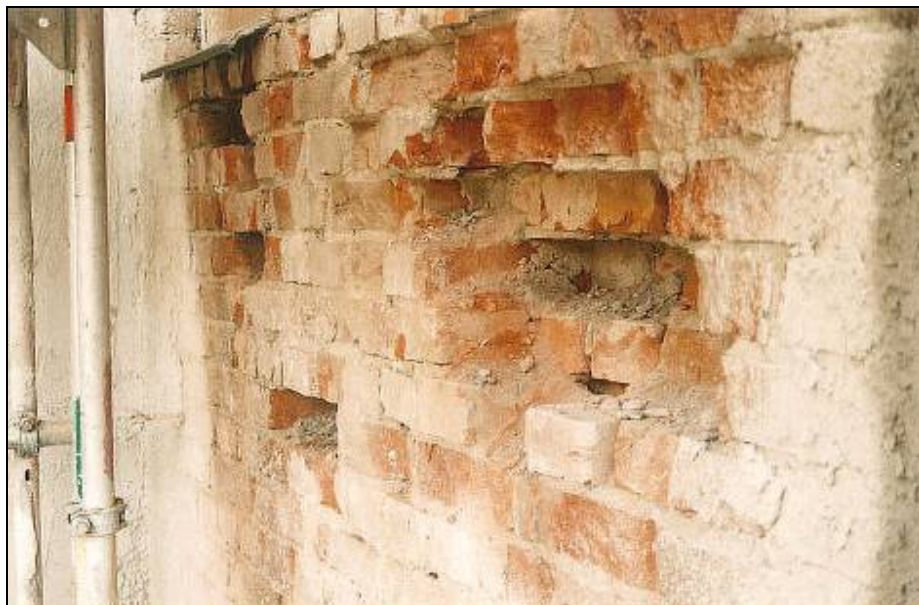
Figur 53. Omfattande skada i tegelmuren efter brister i takavvattningen. Skadat tegel byttes mot nytt. Foto: Helén Sjökvist.
