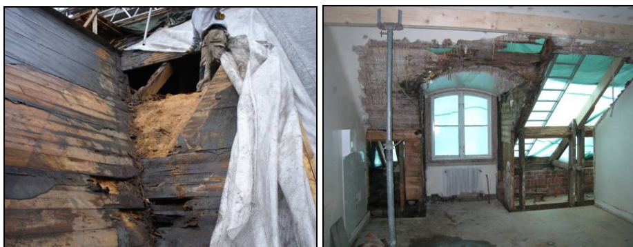
Figur 98. Rötskadat tak efter skadad rännal mellan takfall 3p och 3q. Foto: Lars Larsson.
