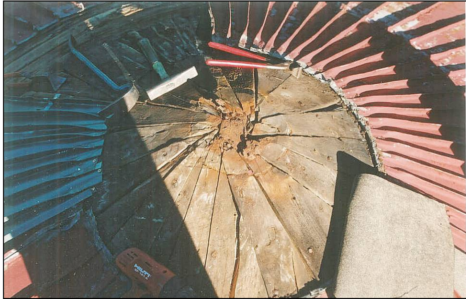
Figur 60. Rötskador i undertakspanelen åtgärdades. Foto: Helén Sjökvist.
