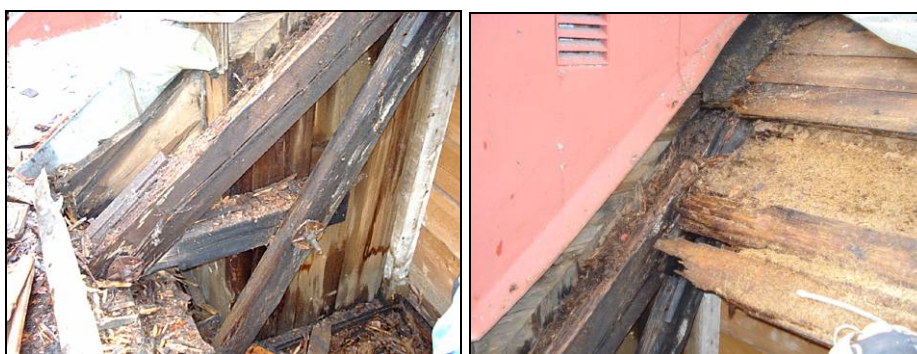
Figur 100. Rötskadat tak fasad 3p. Foto: Lars Larsson.
