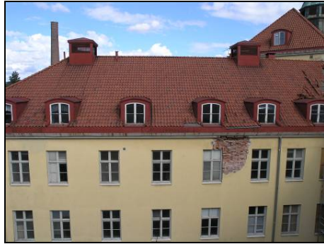
Figur 102. Fasad 3a före åtgärder. Foto: Helén Sjökvist.
