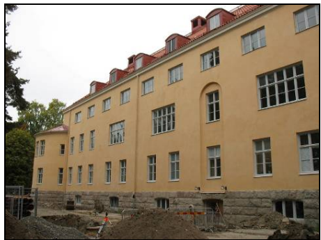
Figur 75. Fasaden mot sydväst efter renoveringen. Samtliga takkupor är bevarade men vissa har försetts med blindfönster. Foto: Helén Sjökvist.
