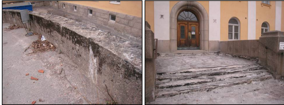
Figur 116. Granitstenarna som täcker muren vid uppfarten till huvudentrén togs bort för att läggas tillbaka i nytt bruk. Muren sandblästrades ren. Foto: Helén Sjökvist.
