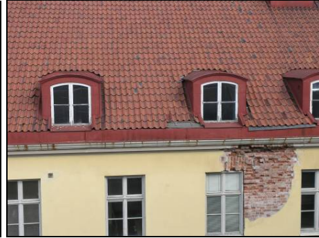
Figur 103. Fasad 3 a med omfattande frostsprängning av tegel på grund av läckage från takavvattning. Foto: Helén Sjökvist.
