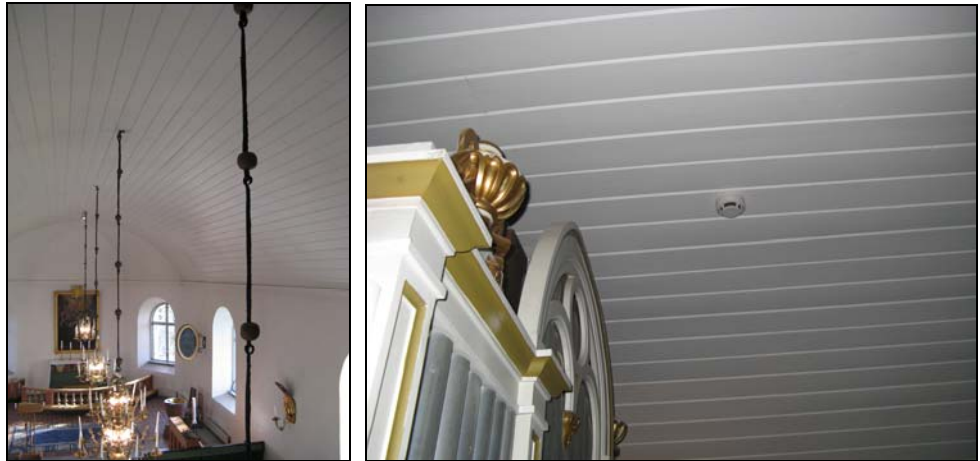
Figur 24. Tunnvalvet före montering av detektorer. Foto: Helén Sjökvist.
