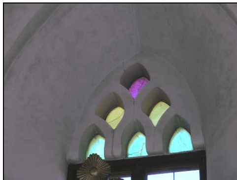
Figur 30. Sprickor i korfönstrets glas. Foto: Helén Sjökvist.
