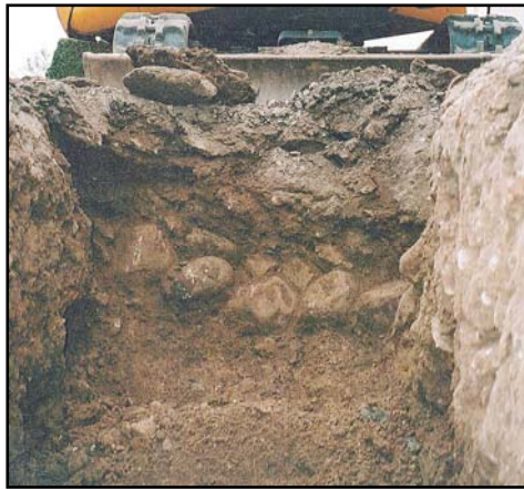
Figur 8. Bergvärmeschaktet öster om slottet med en av de två stenfyllda dräneringsrännorna. (Foto från norr U. Alström.)
