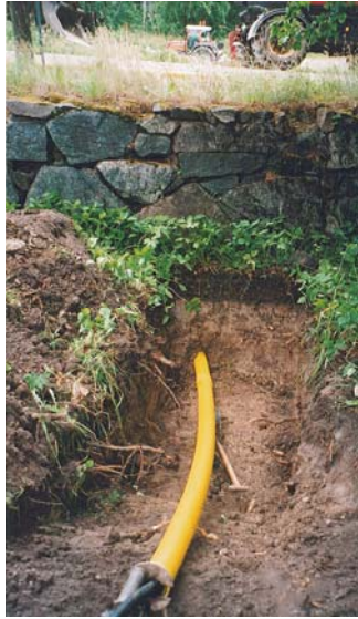
Figur 12. Borrning för elkabel under Slottsvägen och muren som delvis omgärdar Lustträdgården. (Foto från söder U. Alström).
