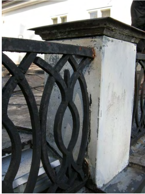
Figur 19. RÄcke och balusterdocka före renovering.
