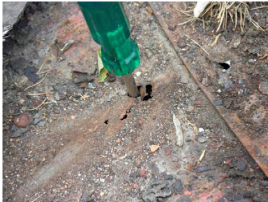
Figur 7. Rostskador och mekaniska skador i ränndalarna. Foto: Krister Berggren
