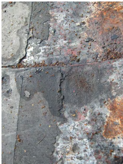
Figur 9. Rostskador, hagmanit armerat med glasfiber.
