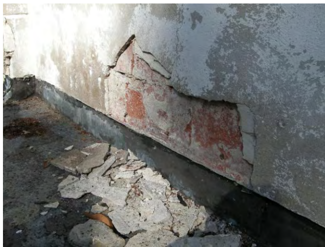
Figur 16. Puttskador i vägg.
