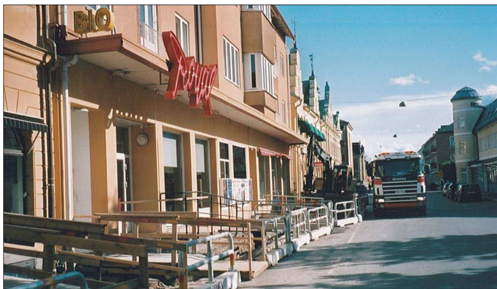
Figur 1. Fjärrvärmeschaktet på östra sidan av Västra Långgatan. Foto från norr. (Foto U. Alström.)
