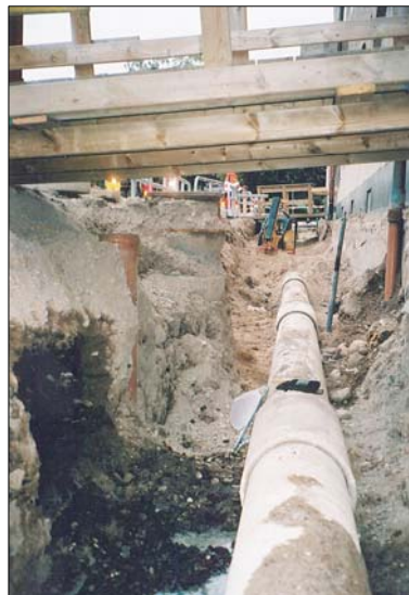
Figur 3. Fjärrvärmeschaktet mot norr. Rören i bild tillhör den gamla fjärrvärmeanläggningen. I schaktkanten till vänster i bild finns kvarvarande kulturlager. Här ritades den norra sektionen. Foto från söder (Foto U. Alström.)
