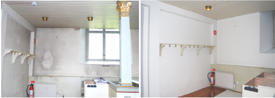
T.v. Bild 9. Väggyta under läktare innan åtgärd. Foto: Nils-Gunnar Karlsson.
