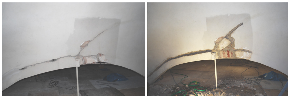
T.v. Bild 27. Skadad valvbåge. Foto: Nils-Gunnar Karlsson.
