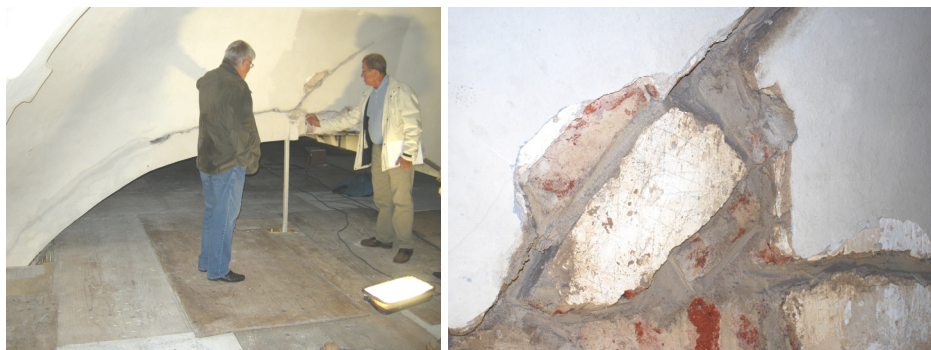
T.v. Bild 29. Inspektion av valvbågens skador. Foto: Anna Gütthlein.
