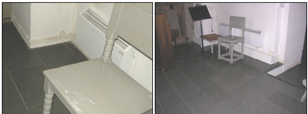
T.v. Bild 15. Norra korväggens kabeldragning samt radiatorer innan åtgärder. Foto: Boel Melin.
