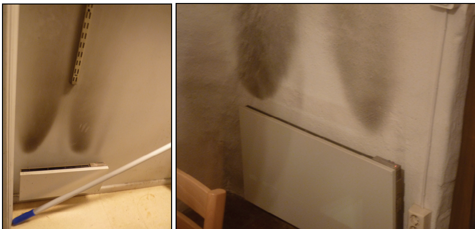
T.v. Bild 20. Äldre radiator i det södra förrådet. Orsakade nedsmutsning av vägg. Foto: Boel Melin.
