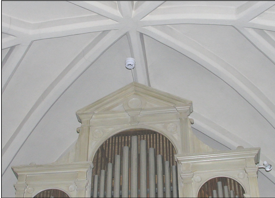
Bild 11. Rökdetektor monterad på orgeltak sedd från mittgång. Foto: Sören Andersson.
