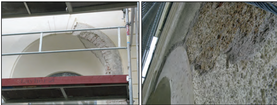
T.v. Bild 20. Nedfallen puts vid fönsteromfattning på norra fasaden. Foto: Boel Melin.
