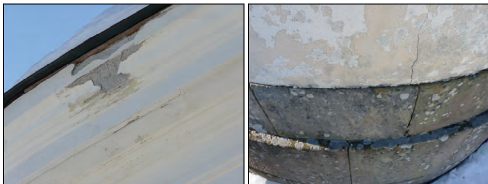
T.v. Bild 26. Putsskada vid taklist. Foto: Boel Melin.
