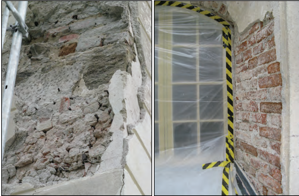
T.v. Bild 18. Putsen på hörnkedjorna var mycket skadad och föll av i stora sjö. Bilden visar delar av den äldre underliggande putsade och pikebuggna hörnkedjan. Foto: Boel Melin.
