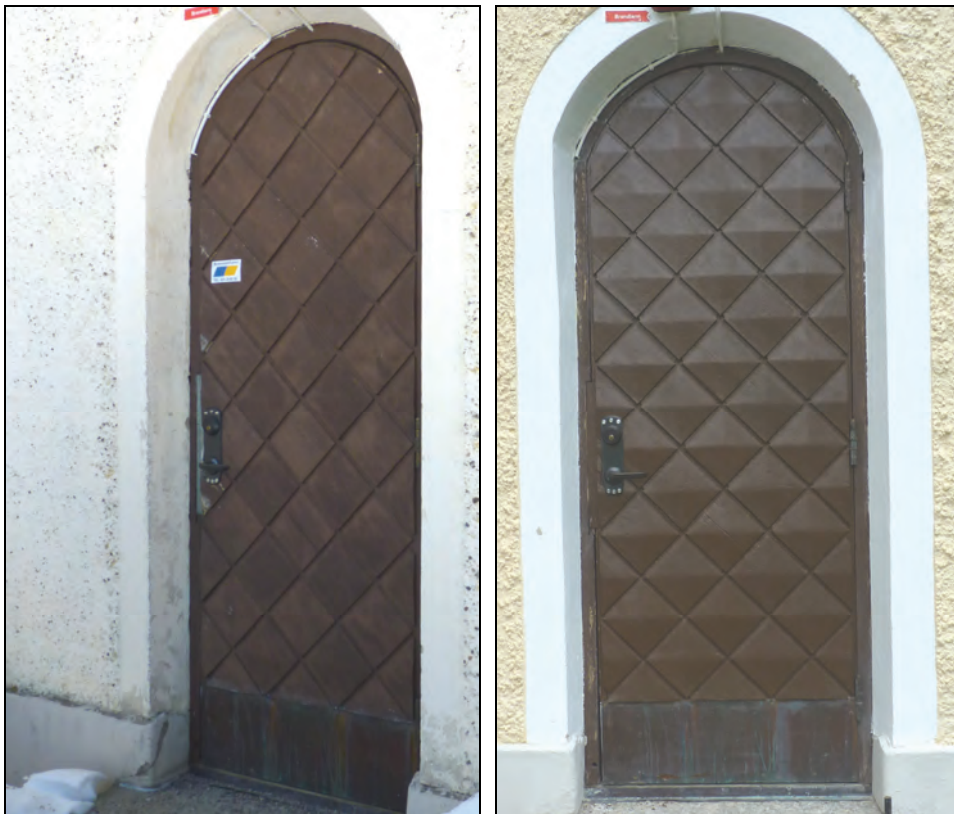
T.v. Bild 56. Sakristians dörrblad uppvisade sprickor och rötskador. Foto: Boel Melin.
