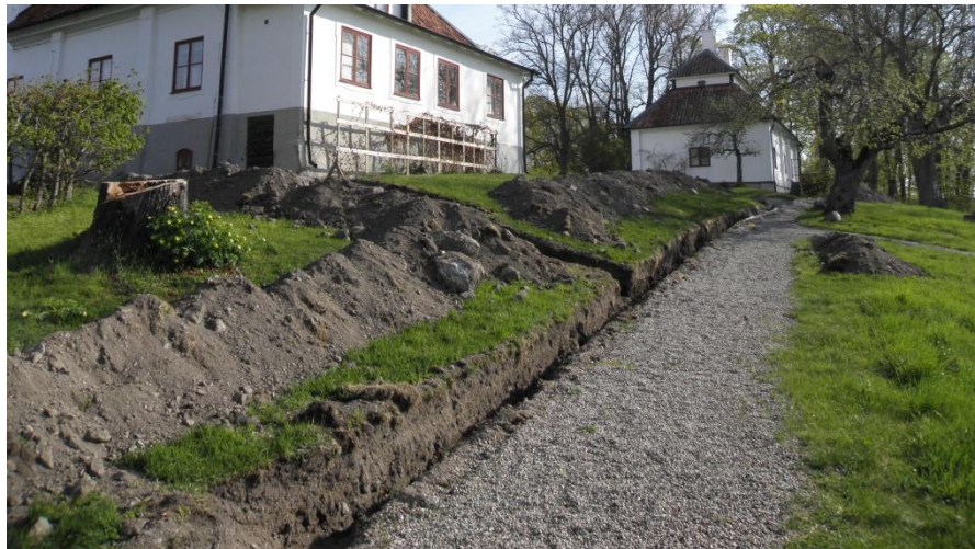
Figur 3. Fjärrvärmeschaktet på södra sidan av mangårdsbyggnaden. Lager 1 befinner sig i schaktet i bildens förgrund och lager 3 i fonden framför södra flygeln. Foto från sydväst.
