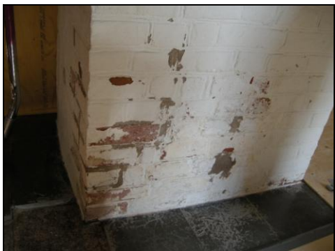
Bild 31. Ytputsbortfall förekom framför allt på pelare. Troligen orsakad av markfukt. Foto: Boel Melin.
