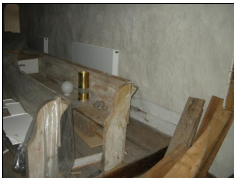
Bild 47. Panelradiatorer på södra läktaren
