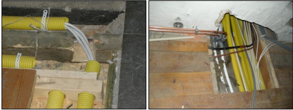
T.v. Bild 23. Ledningsdragnings under trägolvsdelen under kyrksalens kyrkbänkar. Foto: Boel Melin.
