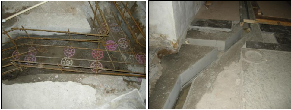
T.v. Bild 6. Vid uppgrävningen av golvet mot södra långväggen blev omfattningen av vatten inträngningen synlig. Bilden visar vattenfylld golvkanal vid södra portalen. Foto: Boel Melin.
