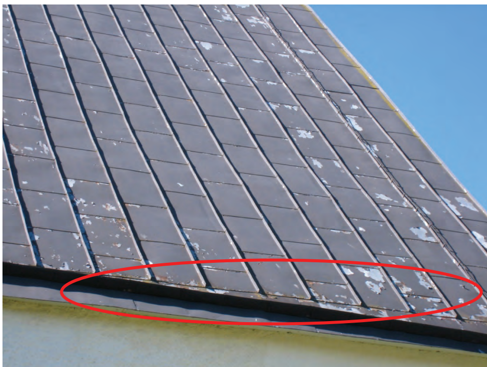
Figur 6. Vissa rostangrepp fanns på takplåten på norra sidan, bland annat i nedre delen mot ständrännan. Foto: Helén Sjökvist.
