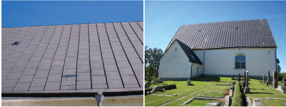
Figur 4. Södra takfallets målade ytskikt var i relativt god kondition och var först ej tänkt att ommålas. Vid närmare besiktning konstaterades dock att grundningen skymtade igenom täckfärgen. Foto: Helén Sjökvist.
