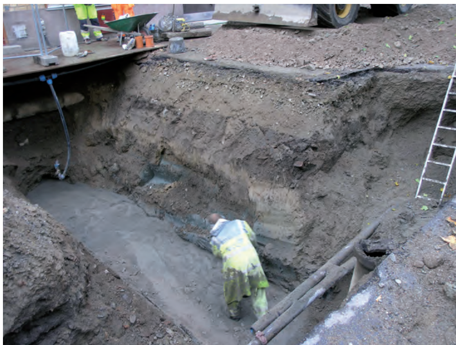
Figur 62. Schaktet vid Punkt 7A och 7B var djupt. Fotografierat från öster av Anna Arnberg.
