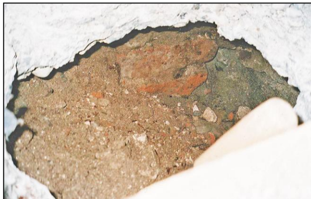
Figur 6. Provplats 5 i sakristian med ett parti murat tegel som ev. kan vara en del av en vinkällare. (Foto U. Alström.)
