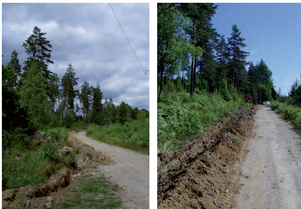
Figur 2. Ledningsschaktet förlades till den nordvästra kanten av den grusväg som löpte genom området. Till vänster syns schaktets södra del och till höger dess norra del. Foto Britta Kihlstedt.
