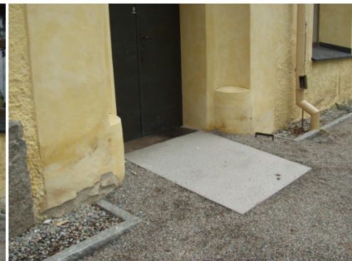
Figur 27. Ny ramp till södra entrén med släntat parti av grus. Foto: Lisa Skanser.
