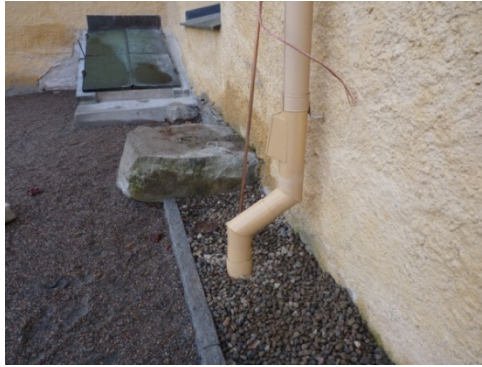
Figur 23. I bakgrunden syns den nya källartrappan med återanvända dörrblad. I förgrunden nya stuprörsanslutningar. Foto: Helén Sjökvist.
