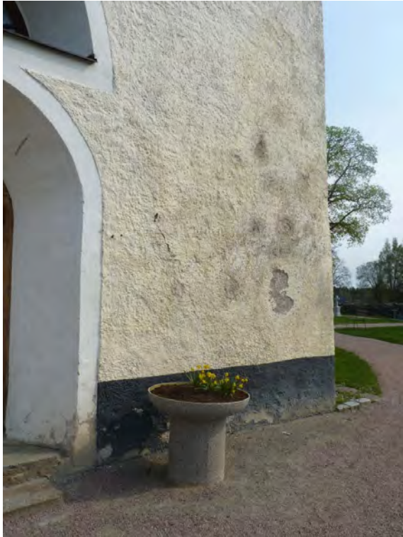
KM11048 Irsta ka 20110426-37. Skador i tornets puts innan åtgärder. Foto: Boel Melin.
