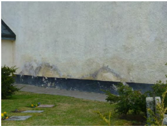
KM11048 Irsta ka 20110426-52. Skador på långhusets norra fasad innan åtgärder. Foto: Boel Melin.
