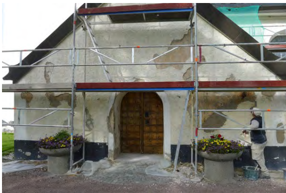
Putslagningar på vapenuset. Foto: Peter Breiman.
