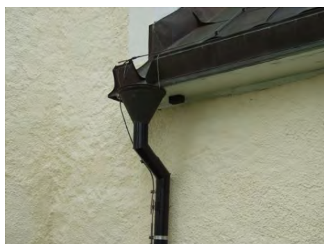
KM11124 Irsta ka 20120710-3. Närbild på stuprör vid vapenbusets västra hörn efter åtgärd. Foto: Lisa Skanser.
