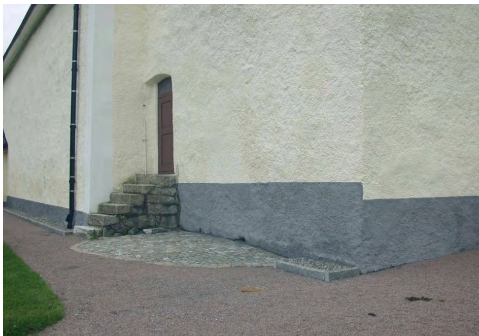
KM11048 Irsta ka 20120710-130. Del av tornets och långhusets norra fasader efter genomförda putslagningar och avfärgning. Foto: Lisa Skanser.
