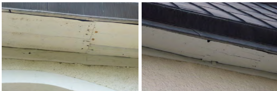
T.v. KM11048 Irsta ka 20110426-94. Takfotsbräder innan åtgärd. Foto: Boel Melin.
