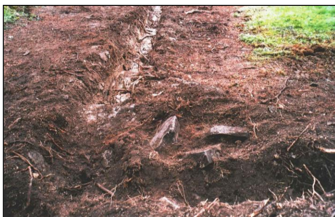
Figur 6. Kyrkans sydvästra hörn med delar av stenskoningen. I de grävda diken ska nya häckplanteras. (Foto från söder, U. Alström.)
