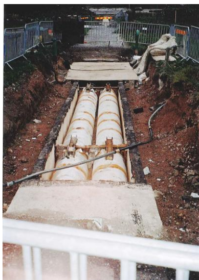
Figur 2. Del av fjärrvärmekulverten i schakt 1 där schaktmassorna bestod av gruslager och lera. (Foto från sydväst U. Alström.)
