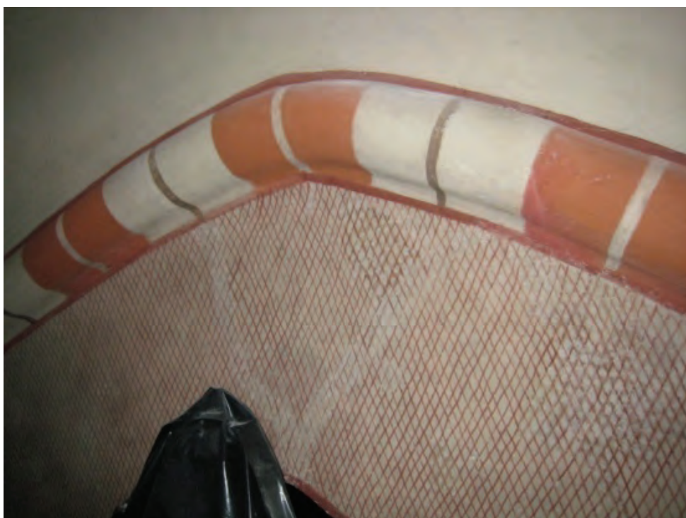
Figur 19. Spricklagningar mellan travé ett och två. Foto: Helén Sjökvist.
