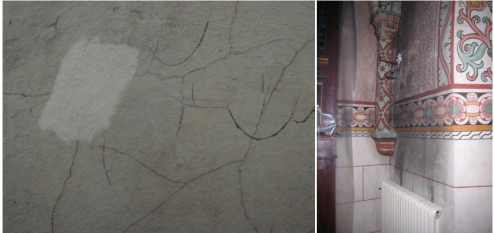
Figur 11. Provren gjord yta i valvkapporna i det sydvästra valvet. Sprickebildningen är tydlig före rengöring. Nälsprickorna försvinner efter rengöring med gomma pane. Foto: Helén Sjökvist. Figur 12. Kraftigt smutsat parti över radiator vid orgeln. Foto: Helén Sjökvist.
