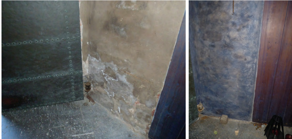
Figur 71. Vindfång med puts-skador i nedre delen, samt lagningar med för hårt cementhaltigt bruk som inte heller hade anfärgats som ursprunget. Foto: Helén Sjökvist.
