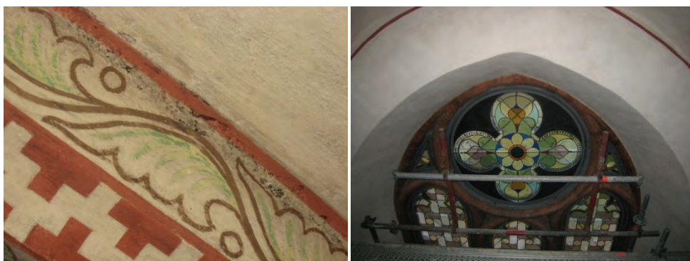
Figur 34 På några ställen är putsen väldigt grov nära inpå ribborna och det uppstår små håligheter i putsen. Foto: Helén Sjökvist.
