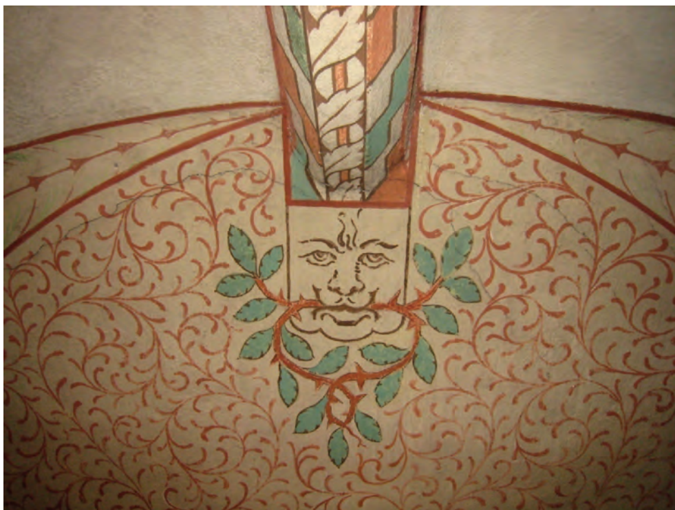
Figur 23. En "grön man" på västra väggen med sprickbildning Foto: Helén Sjökvist.
