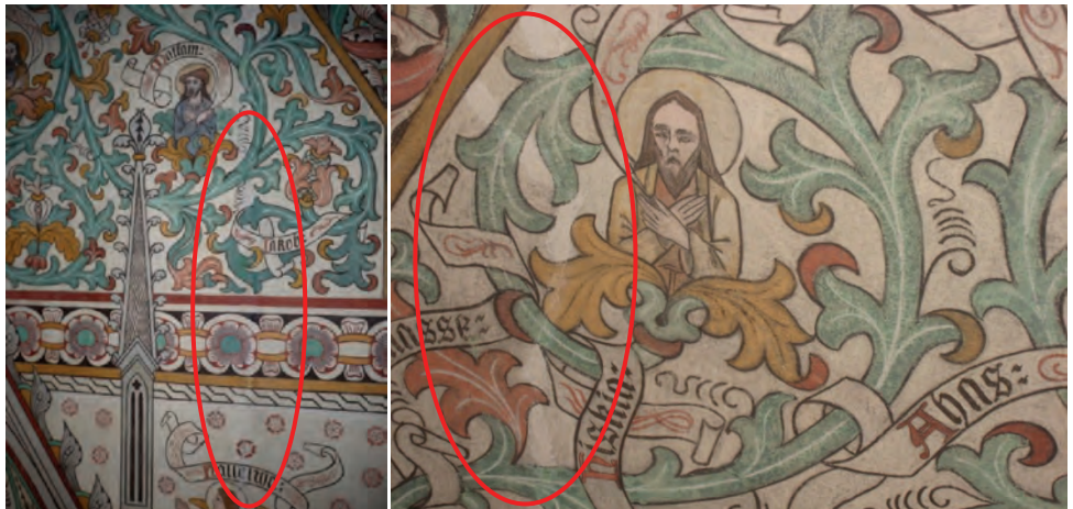
Figur 38 Område som spricklagats. Jämför figur 37. Foto: Helén Sjökvist.
