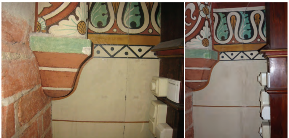
Figur 15. Spricka som uppkommit mellan trä och puts vid orgel. Foto: Helén Sjökvist. Figur 16. Sprickan lagad och intonad på de kvadermålade partierna. I de dekorationsmålade partierna fick sprickan vara kvar. Slagskadan på valvanfanget har lagats upp och retuscherats. Foto: Helén Sjökvist.
