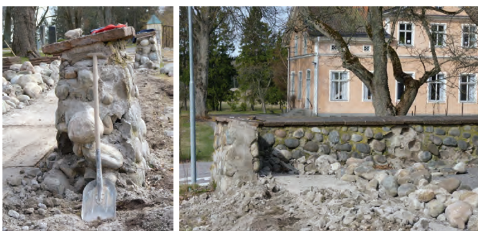
Figur 18. Kvarstående parti av den södra muren. Muren är uppförd i fältsten med dålig sammanbindning mellan skalmurar och kärna. Foto: Helén Sjökvist.
