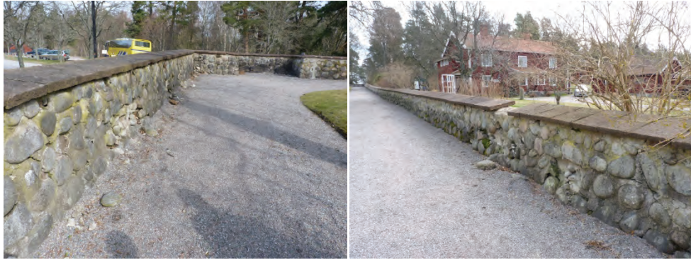
Figur 10. Västra muren mot norr med partier av urfallna stenar. Foto: Helén Sjökvist.
