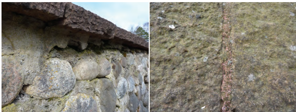
Figur 14. Äldre utjämning under kalkstensplattor med urlakat bruk. Foto: Helén Sjökvist.
