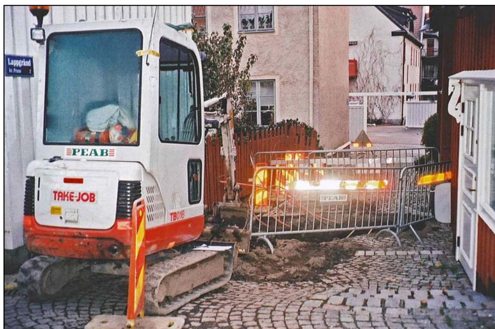
Figur 1. Schaktning på grund av vattenläcka i Lappgränd 30 oktober 2012. (Foto från väst U. Alström.)
