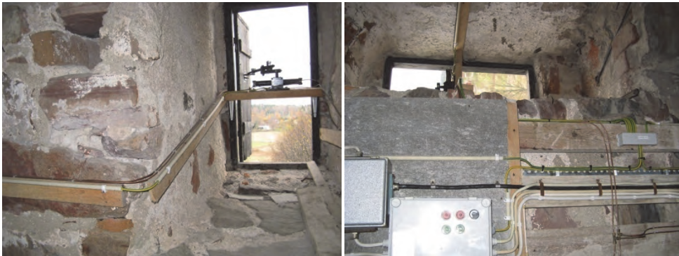
Figur 28 och 29. Den grön-gula kabeln är nytillkommen och ansluter lucköppningsautomatiken till potentialutjämnningen. Helén Sjökvist.
