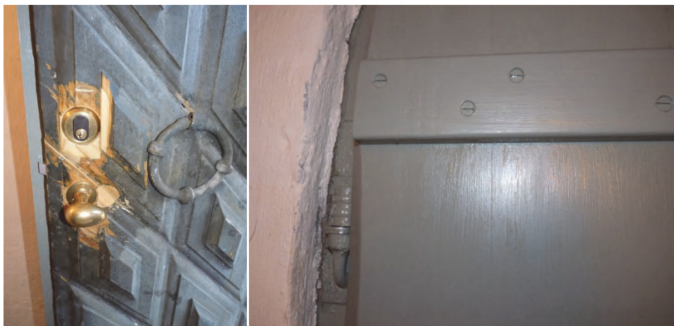
Figur 77. Fina trälagningar har utförts på grund av skador efter tidigare låskista och bleck. Foto: Helén Sjökvist.
