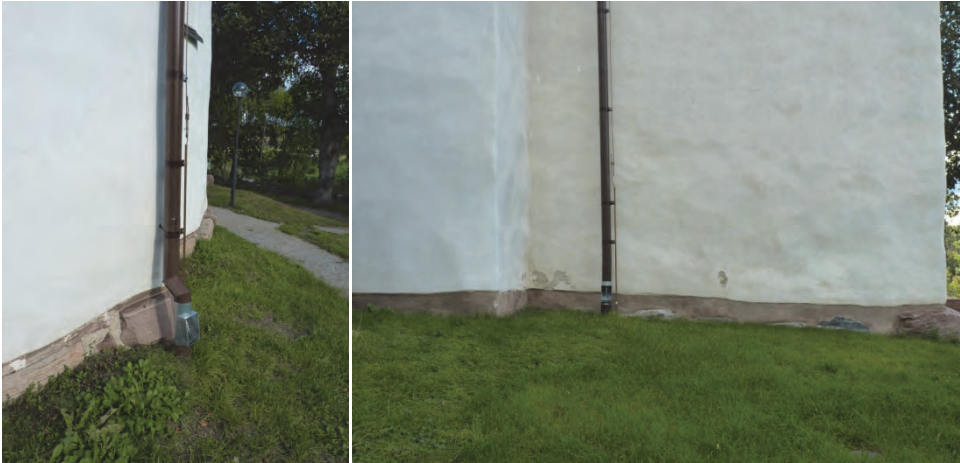
Figur 26 och 27. Gräsmattan återställd och stuprören anslutna till det markförlagda systemet. Lövsilarna är senare inmålade i samma kulör som stuprören. Foto: Helén Sjökvist.
