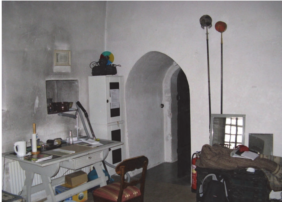
Figur 46. Sakristian med starkt smutsade väggar före åtgärder. Helén Sjökvist.
