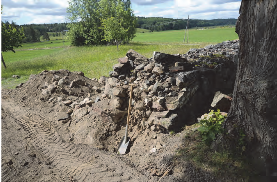
Figur 39. Murens utseende mot väster efter genombrott. Hela muren är kallmurad och uppförd med en skalmur med större, väl valda stenar utåt och mindre fältstenar som fyllnad i mitten. Foto: Gunilla Nilsson, Svensk klimatstyrning.
