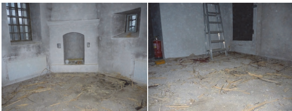
Figur 51. Trägolvet borttaget. Väggarna kraftigt smutsade. Foto: Helén Sjökvist.
