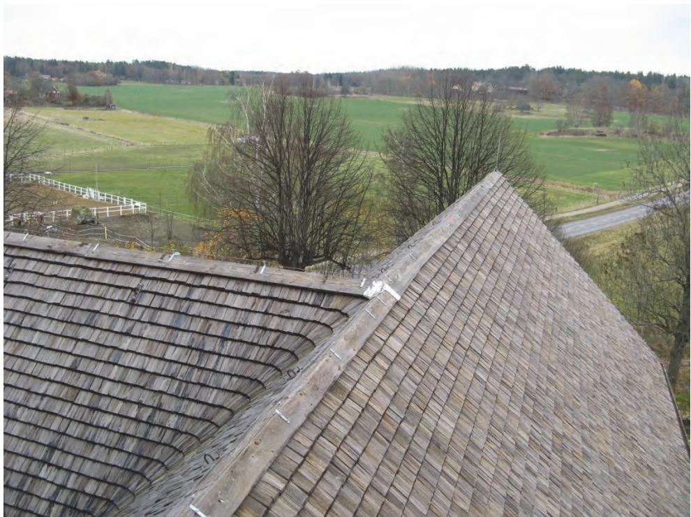
Figur 34. Åskeledare monterad på långbustak och norra sidoskeppet. Helén Sjökvist.
