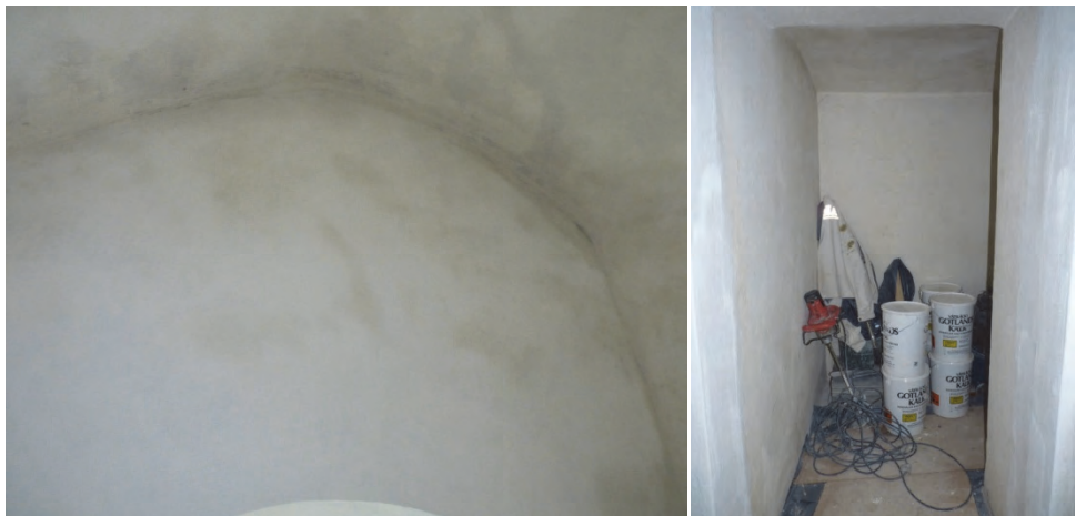
Figur 57. Norra väggen över fönster. Spricklagningar ansas fortfarande efter tre strykningar. Helén Sjökvist.
